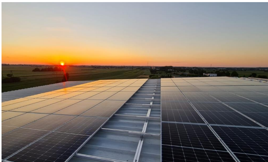
Fot. 13 Instalacja dachowa MŚP
