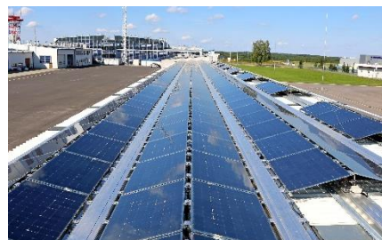
Fot. 18 Instalacja PV na dachu przedsiębiorstwa
