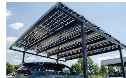
Fot. 12 Fotowoltaiczny carport
