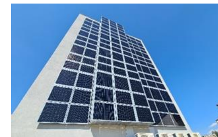
Fot. 18 Instalacja PV na fasadzie budynku
