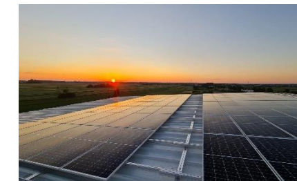
Fot. 41 Instalacja PV na dachu firmy
