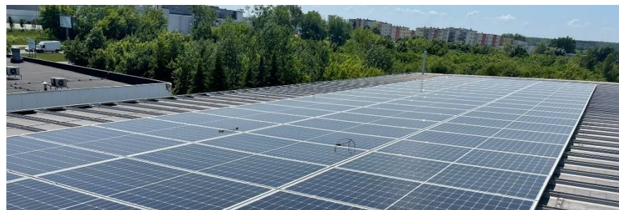
Fot. 58 Dachowa instalacja fotowoltaiczna, siedziba firmy Lubella w Lublinie
