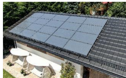
Fot. 40 Kolorowe moduły PV na dachu domu jednorodzinnego
