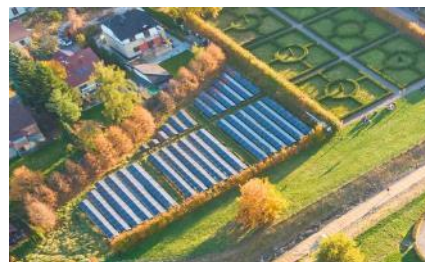
Fot. 38 Klasyczne moduły PV na gruncie
