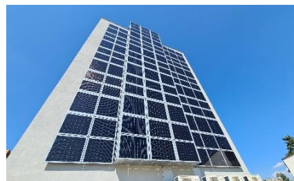
Fot. 43 Moduły klasyczne PV na ścianie budynku
