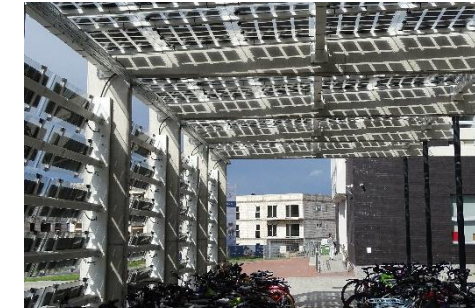
Fot. 17 Zadaszenie fotowoltaiczne
