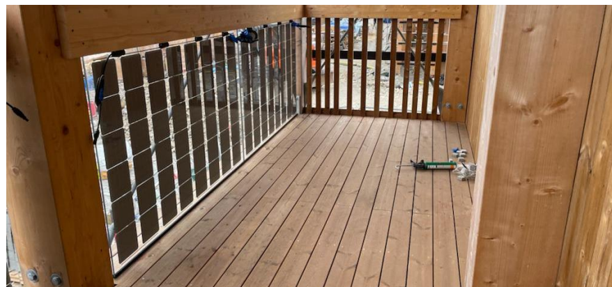
Fot. 62 Balustrady z modułami BIPV, budynek wielolokalowy, Szwecja
