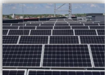
Fotowoltaiczne instalacje na dachu
